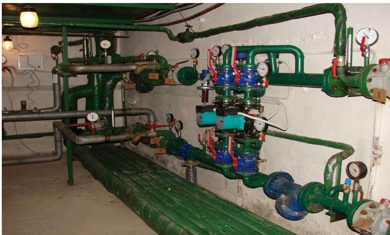
Рис. 3.11. Теплопункт ТП-1 в навчальному корпусі № 1
