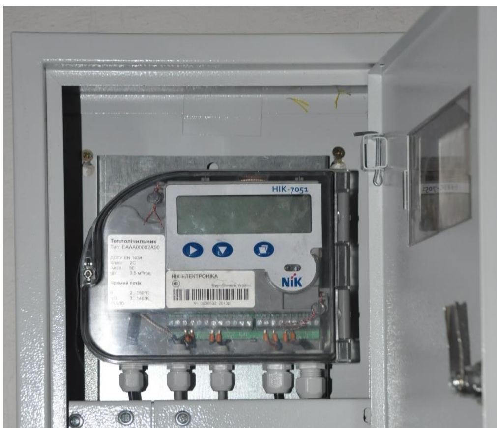
Рис. 3.14. Теплолічильник «НИК-7051», в тепlopункті навчального корпусу № 4
