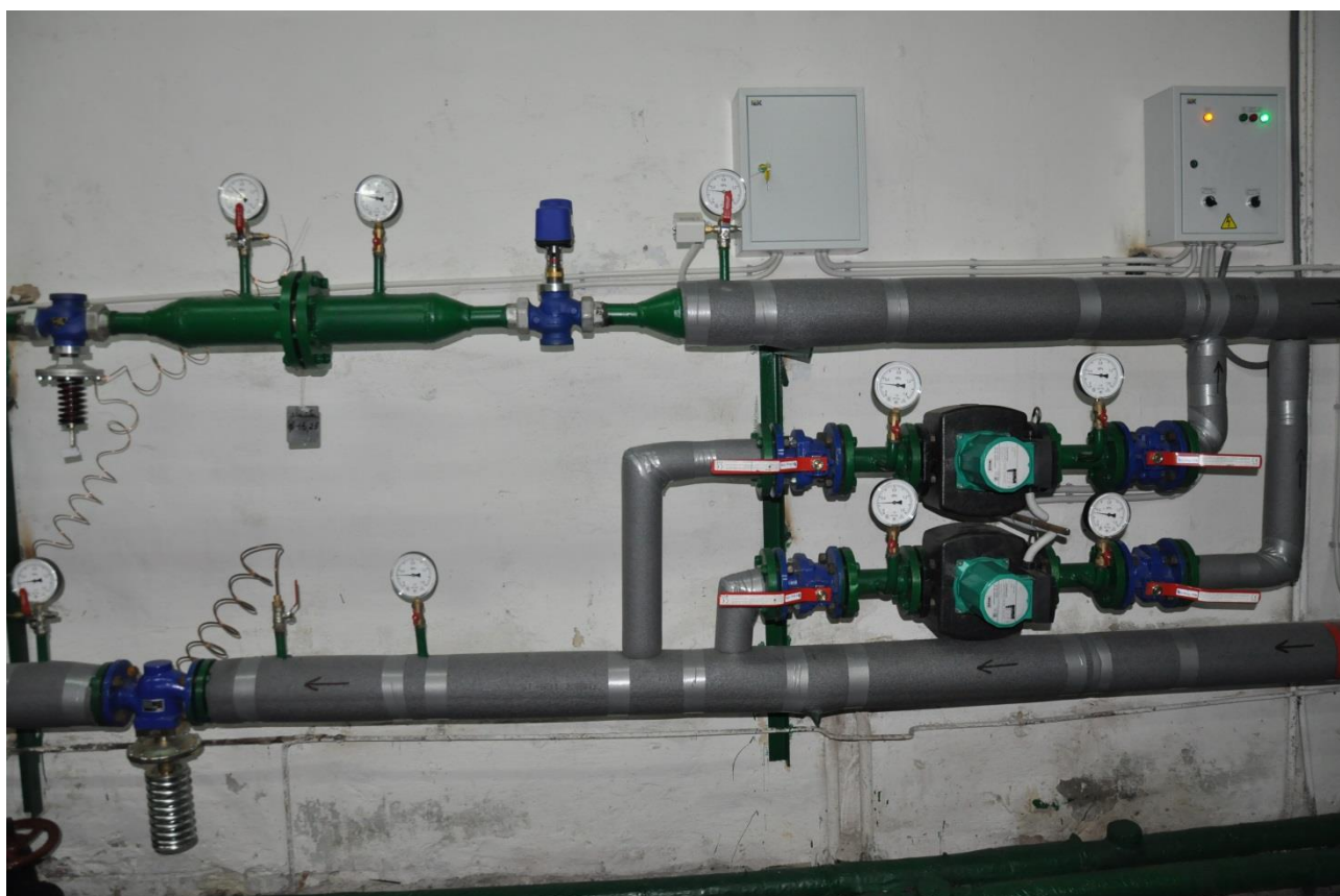
Рис. 3.12. Теплопункт ТП-2 в навчальному корпусі № 1 (автогараж)
